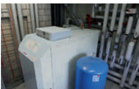
Heizkessel Typ RyllTech R22-150 BC, oben.
